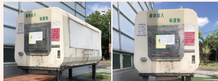
處理廢棄物之機器設備
